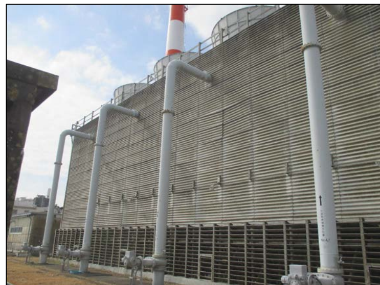
冷却塔倒壊前(H30.2.16撮影)
