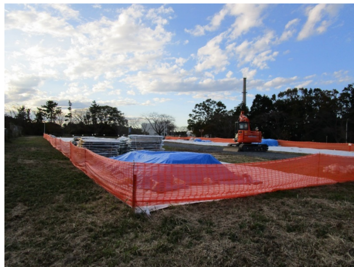
がれき等の保管場所の状況(令和元年11月14日撮影)
